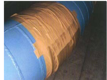
写真 10 破損したパイプ
