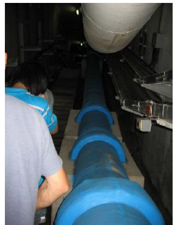
共同溝内部の様子（ベイタウン）
