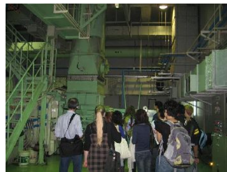
ゴミ空気輸送システムの終着点 幕張クリーンセンター（内部）
